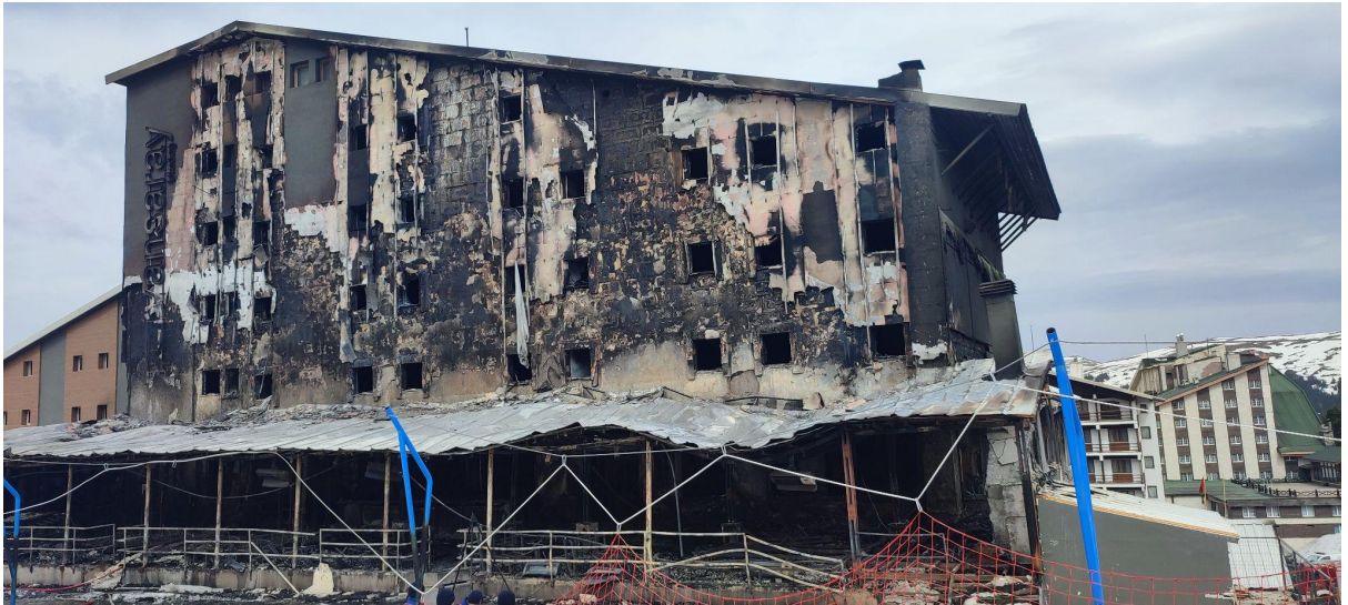
Binanın Yangın Sonrası Durumu
